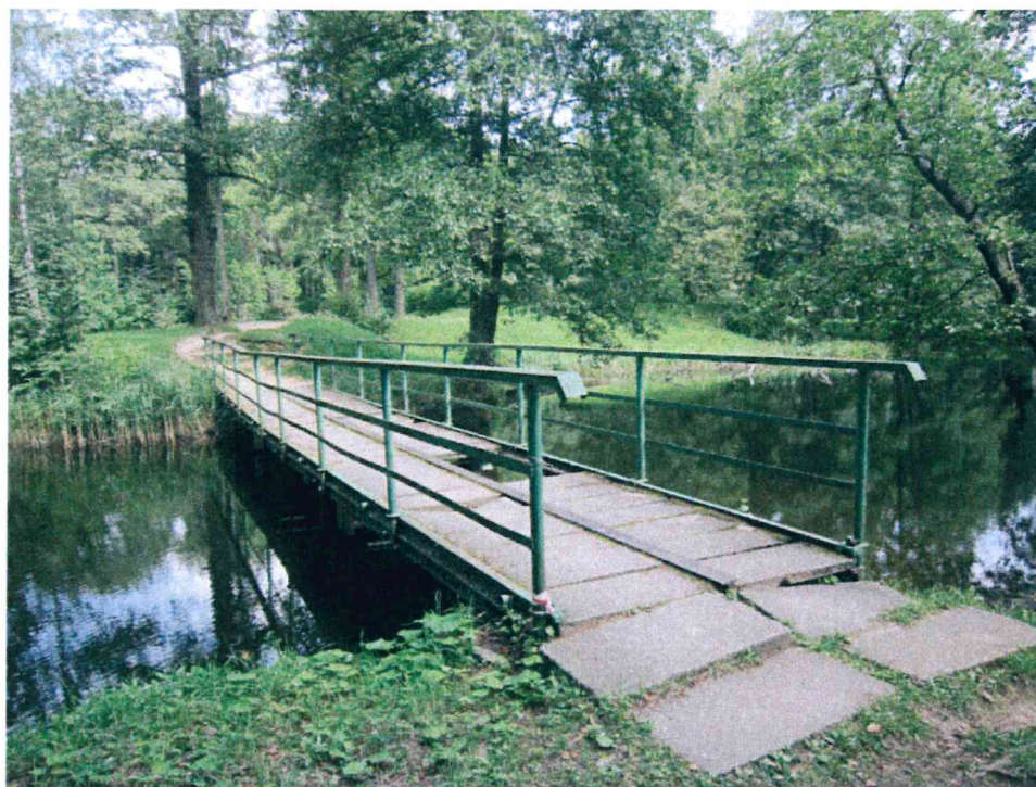
42.att. Apmeklētājiem nedrošs gājēju tiltiņš uz salu, 2014.gada augusts /foto – V.Radziņa/.
