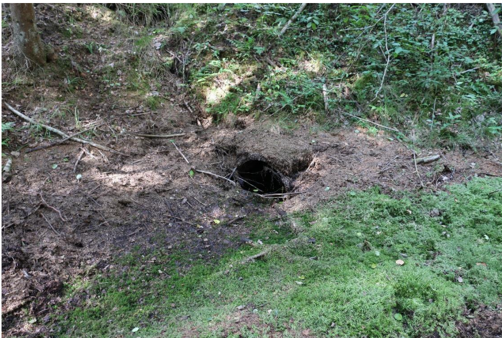
10.8. attēls. Piesērējusi un daļēji aizdambējusies betona caurteka, kas savieno ūdensnotekas purvaino mežu masīva centrālajā daļā (foto: J. Soms, 2021)
