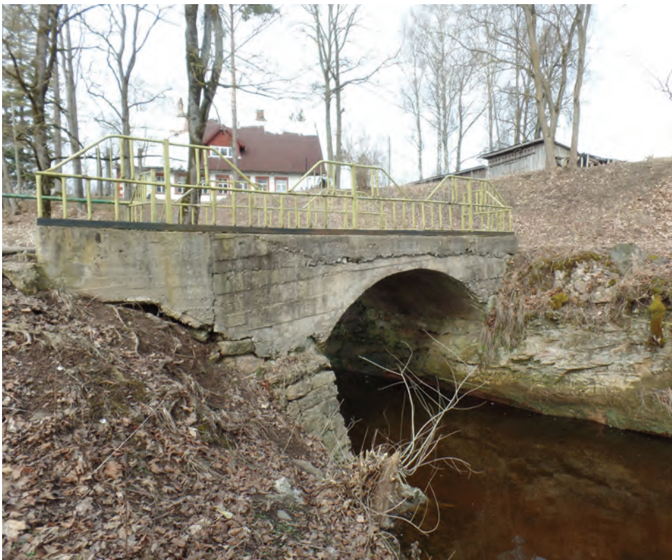
Esošais mūrs tilts pār Rumbiņu rekonstruējams, uzstādāma vienkārša dizaina metāla marga antracīta krāsā
