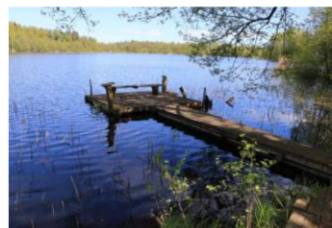
Klaucānu ezerā, pie tā D krasta (pie zemes vienības ar kadastra apzīmējumu 56660030229) izveidotā laipa un skatu platforma ar dēļu segumu. Margas un dēļu segums ir nolietojies un bojāts, un laipas apmeklēšana šobrīd ir bīstama. (Foto J. Soms)
