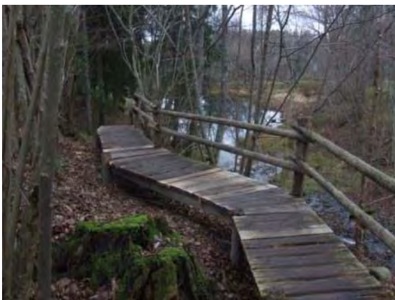
19.attēls. Koka kāpnes (~ 83m garumā), skatoties no augšas, no avotu galvenās iztekas vietas. Lejā redzams dzirnavu dīķis. Kāpnes ar platformām ir nolietojušās, tās jāatjauno.
