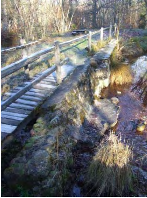
17.attēls. Tiltiņš pāri iztekai no dzirnavu dīķa. Daļa no dzirnavu dīķa dambja ir sagāzusies un balstās uz esošā koka tiltiņa. Pirms jauna tiltiņa uzstādīšanas dambis jāsalabo.
