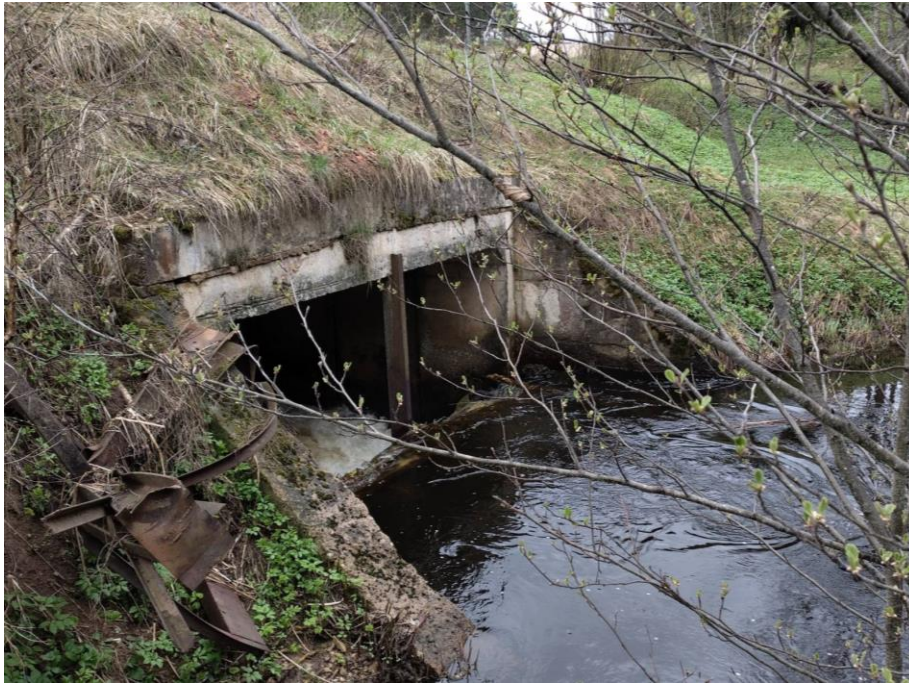
15. attēls. Meļniku aizsprosta caurteka-regulators, augšbjefs – redzamas bojātās (saliektās metāla konstrukcijas) regulatora šandronu vadīklas 2024. gada rudens (2024-04-14, LKS92 x: 747393.5, y:242740.7; skats: A virzienā; autors: A.Kalvāns)
