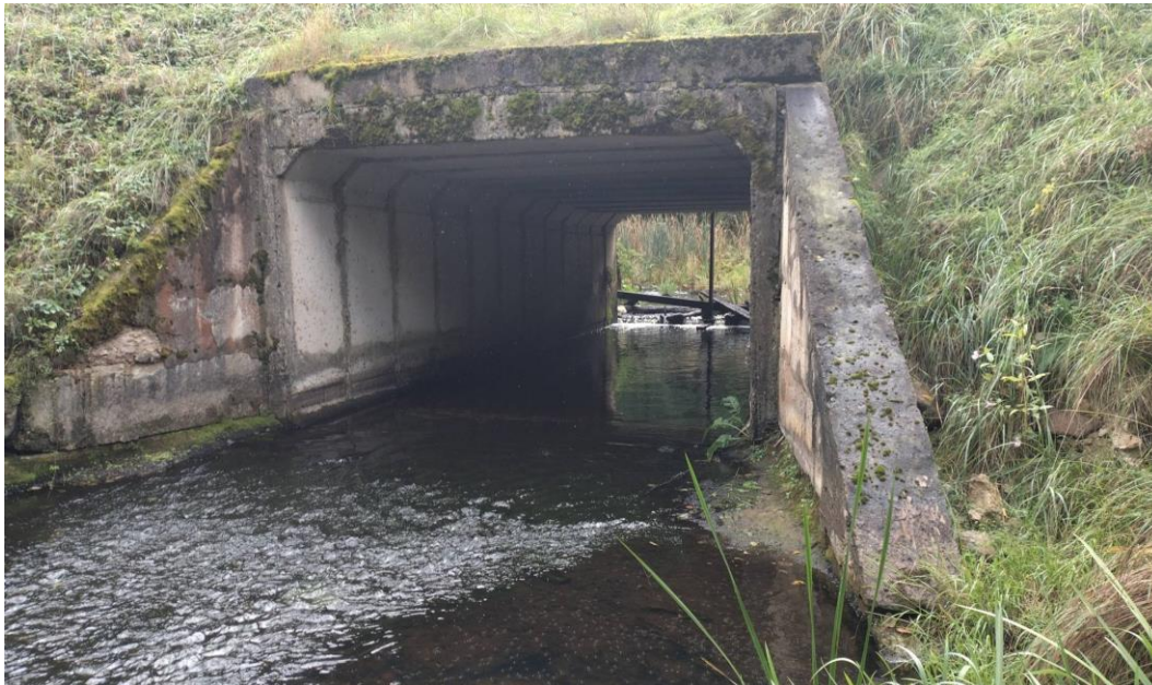
18. attēls. Meļņiku aizsprosta caurteka-regulators, lejasbjefs 2024. gada rudens (2024-09-28, LKS92 x: 747422, y:243253.3; skats: A virzienā; autors: A.Kalvāns)
