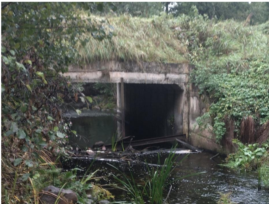
16. attēls. Meļniku aizsprosta caurteka-regulators, augšbjefs – redzamas bojātās (saliektās metāla konstrukcijas) regulatora šandronu vadīklas 2024. gada rudens (2024-09-28, LKS92 x: 747393.5, y:242740.7; skats: A virzienā; autors: A.Kalvāns)
