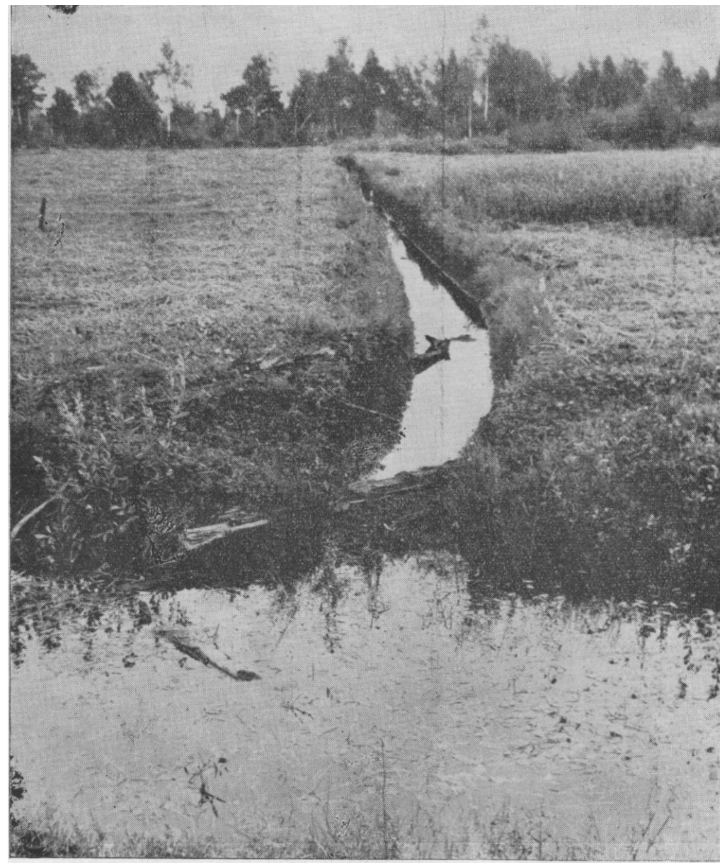
8. attēls. Aizsērējis novadgrāvis (priekšplānā) pilns ūdens
