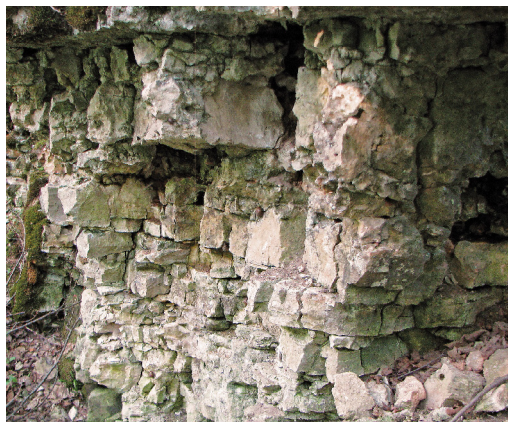
10.7. att. Karbonātisku pamatiežu atsegumu struktūrai raksturīgas horizontālas un vertikālas plaisas. Atsegums Korkuļu sausgultnē. Foto: A. Priede.
