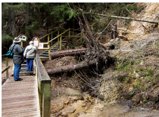
11.28. att. Igaunijā uz smilšakmens atseguma pie Ahjas upes bija plānots nostiprināt kāpnes, taču to balstu izbūve vietā, kur iztecēja avots, izraisīja nogruvumu. Rūpīga grunts izpēte pirms infrastruktūras būves ir svarīga takas plānošanas daļa. Foto: I. Čakare.
