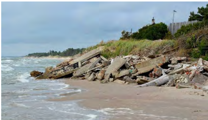
16. attēls. Krasta preterozijas būve – rip-rap krāvums no būvgružiem pie Veckrūmu mājām. Foto: J.Lapinskis
